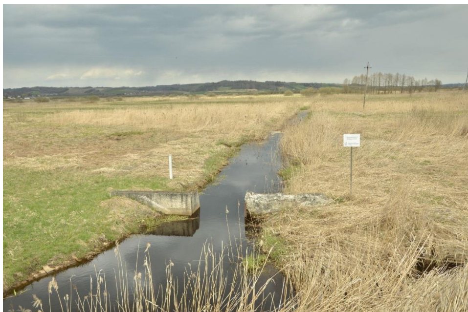
Fot. 40. Jedna z lepiej zachowanych zastawek na rzece Gorajec położona w pobliżu drogi Trzęsiny-Czarnystok
