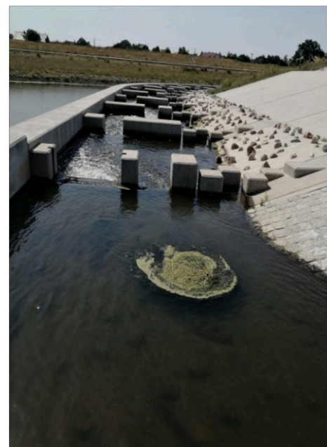
Ryc. 3. Wlot wody do przeplawki II.
