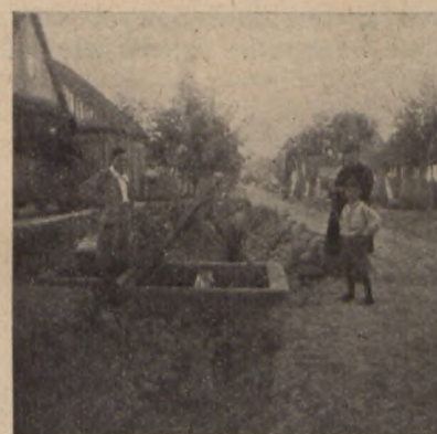
m. Wilejka. Budowa zbiornika le'onowego na wodę opadową. Na pierwszym planie osadnik i filtr.
