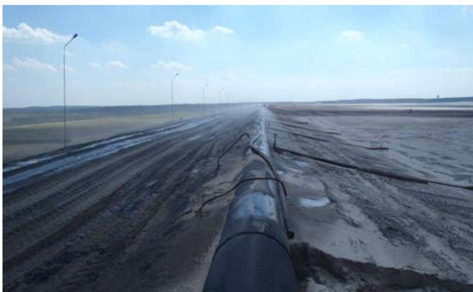
Fot. 4. Deszczownie - rura PE z otworami służąca do zraszania wodą pól wokół korony OUOW. Fot. Albert Muzeja
