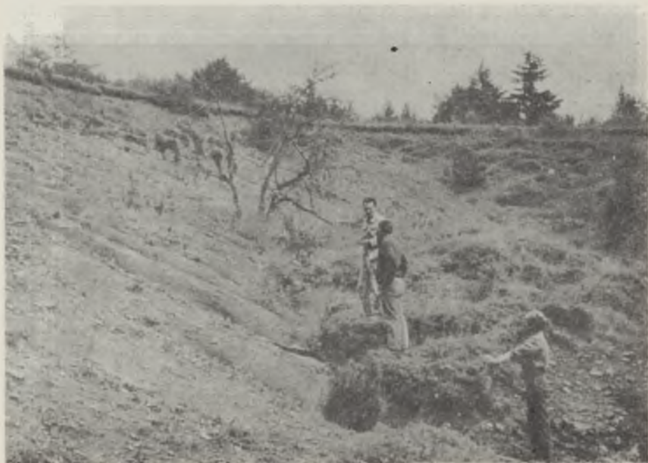
Ryc. 7. Osunięte partie zwietrzelin wypelniające tylną część niszy Slid blocks of weathered rock filling the back part of slide niche
