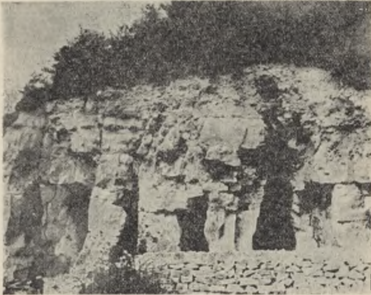
Ryc. 3. Komorowa eksploatacja opoki wzdłuż szczelin diaklazowych. W stropie opoki widoczna warstwa zwietrzliny. Kamieniołom w Bochoćnicy.
