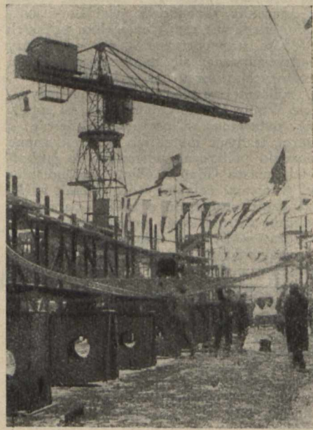
W stoczni gdańskiej. Montowanie jednego z liczby 2 okrętów pasażerskich, budowanych na zamówienie rządu polskiego.
