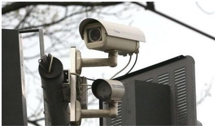
Rysunek 8. Video detektor ruchu drogowego umieszczony na sygnalizatorze świetlnym
