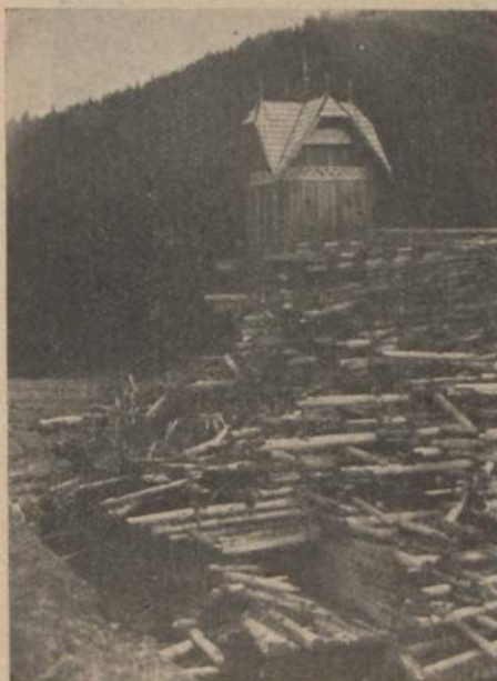
Zniszczona wskutek powodzi w r. 1927 klauza w Probijnie.
