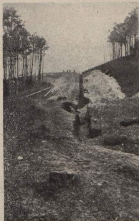
Gdynia. Ciąg tłoczny o średnicy 400 m/m. do zbiornika wodociągowego.
