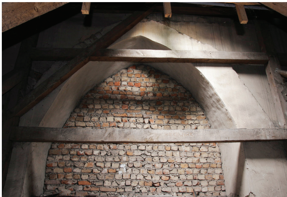
Ilustracja 6. Kościół farny we Wrześni – widok z poddasza nawy południowej na gotycką arkadę międzynawową, fot. M. Potocki (2009)
