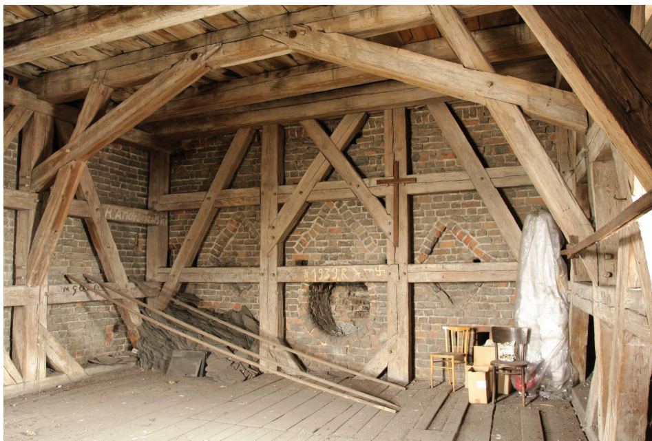
Ilustracja 4. Kościół farny we Wrześni – pozostałości dekoracji fasady korpusu pierwszej fazy. Widok z wnętrza wieży, fot. M. Potocki (2009)
