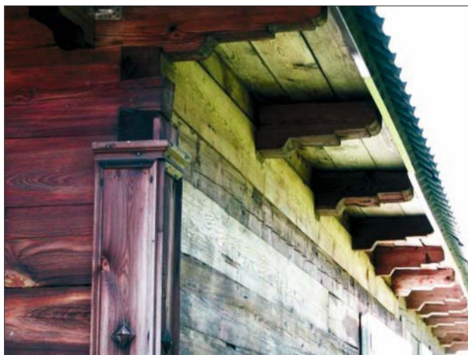
Ryc. 2. Dekoracyjne, zaciosane, podokapowe zakończenia drewnianych belek na budynku mieszkalnym we wsi Soce Decorative tips of timbers on the house building in Soce village
